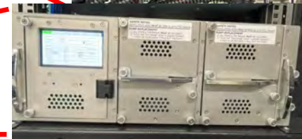
In Rack CDU(ラック毎)
