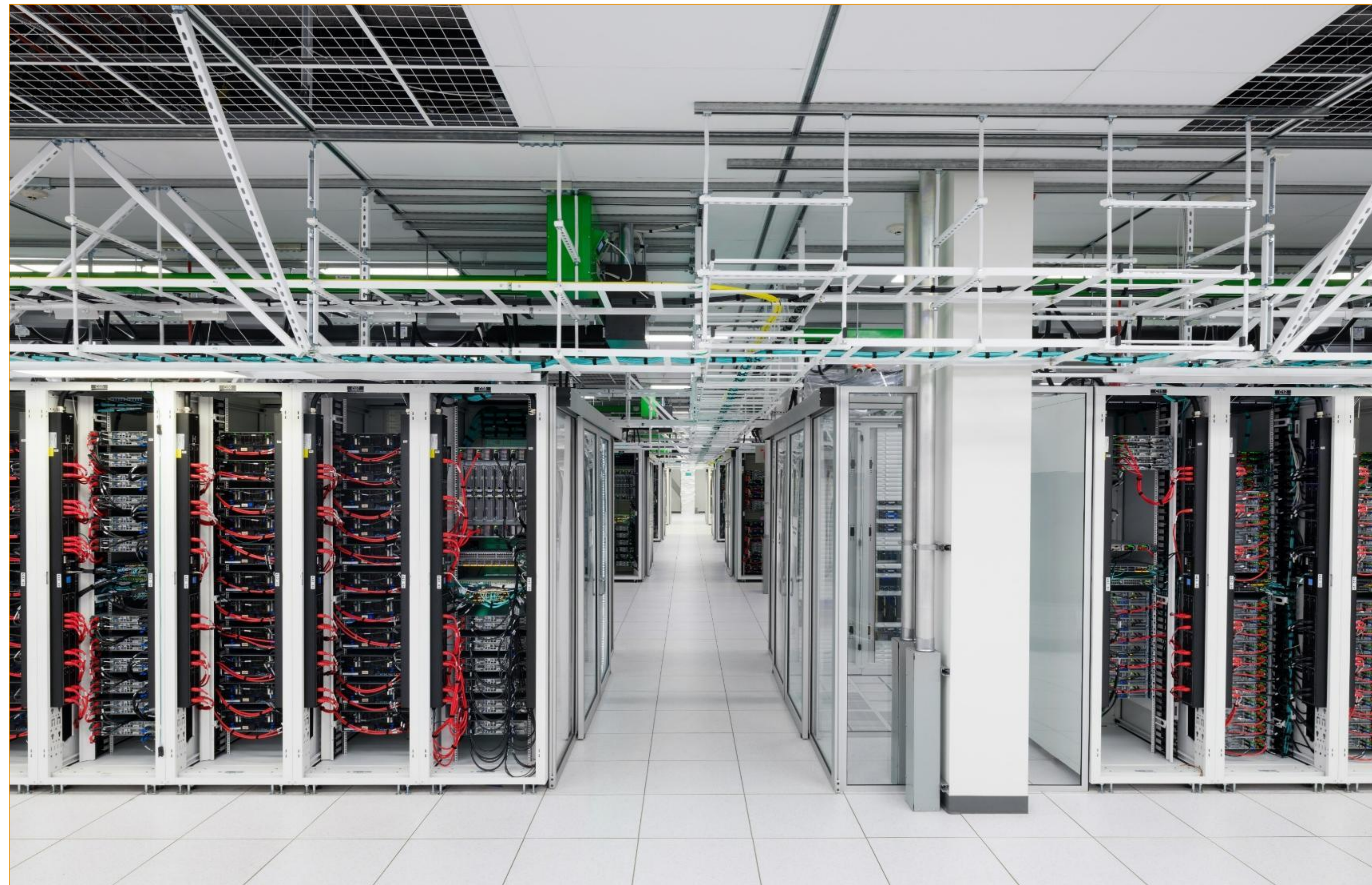
従来型クラウドデータセンター
